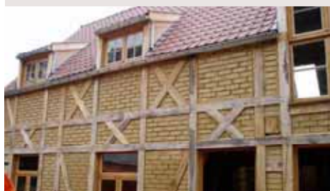
5 Bâtiment des Monuments et Sites Colombages et argile Vakwerkhuis in klei geklasseerd werd als Erfgoed
